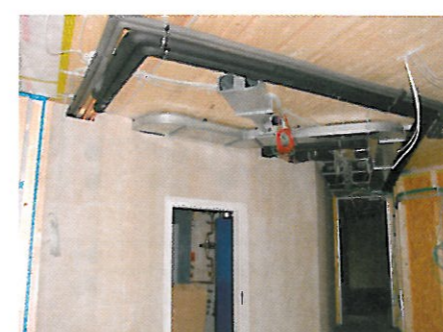
Absaugung der verbrauchten Raumluft über Lüftungsgitter unterhalb der Decken
